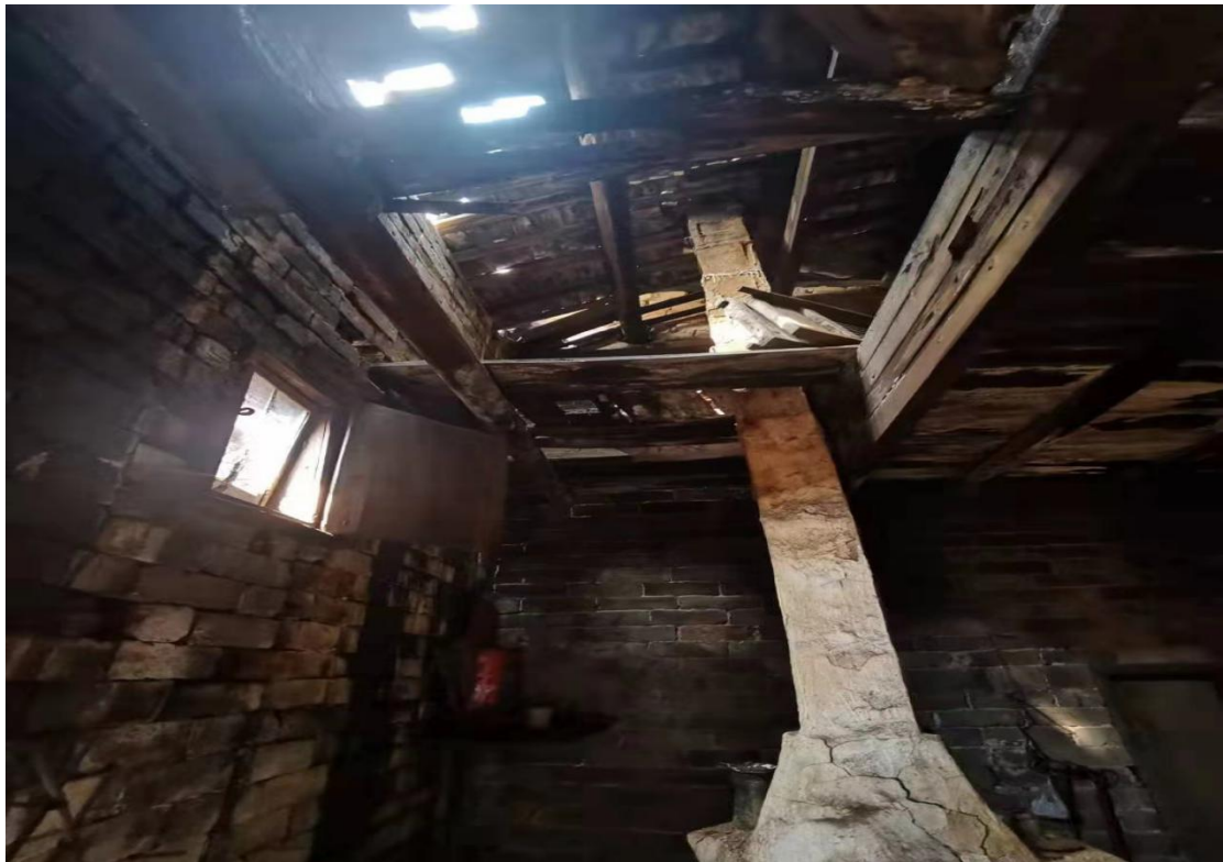
(陈氏民居) 屋顶大梁稀疏脆裂
