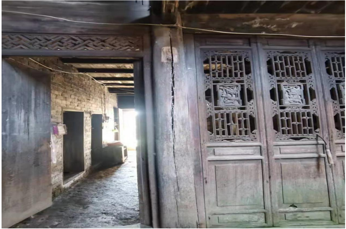
(陈氏民居) 多处承重柱存在较大裂缝
